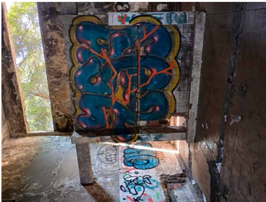
Fig. 3. Interior del ex Fuerte El Morro que reflejan el deterioro del sitio Fuente: registro propio.
